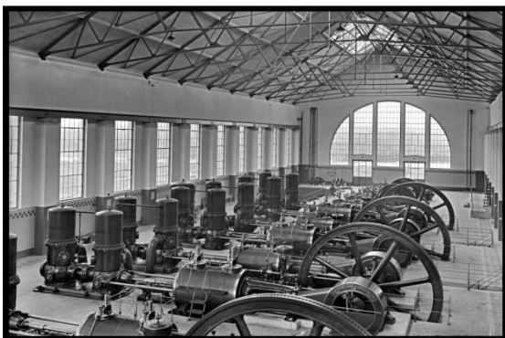
Obr. 1. Plunžrová čerpadla ve strojovně
